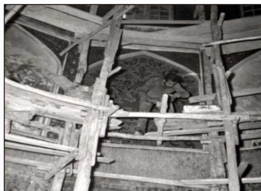
شکل ۱۵. مرمت بخش‌های فوقانی بقعه شاه‌عباس ثانی ۱۳۵۰ ش. احتمالاً جایجایی ورودی‌های بقعه هم در همین زمان صورت گرفته است. منبع: آرشیو تصاویر حرم حضرت معصومه سلام‌الله علیها
